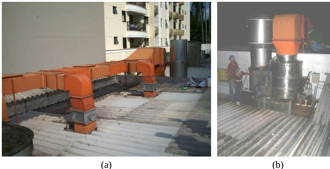
Figura 6 – (a) sistema de dutos de exaustão externo e (b) Precipitador Hidrodinâmico com tecnologia multiventuri.
