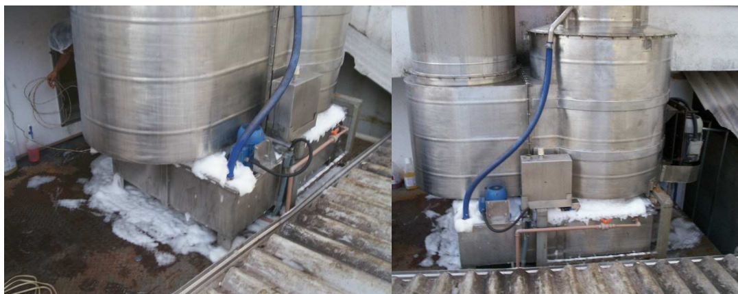
Figura 34 – Lavador de gases.
