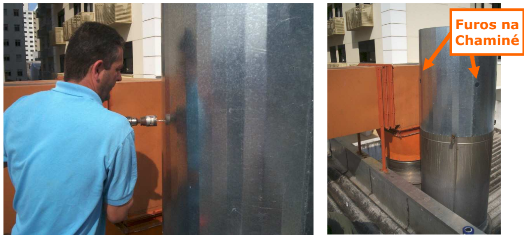
Figura 9 – Furos na chaminé: (a) Momento da execução, (b) prolongamento da chaminé com furos.
