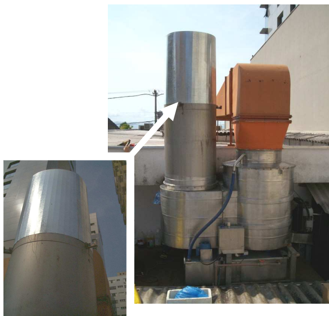
Figura 7 – Prolongamento da chaminé do lavador de gases.
